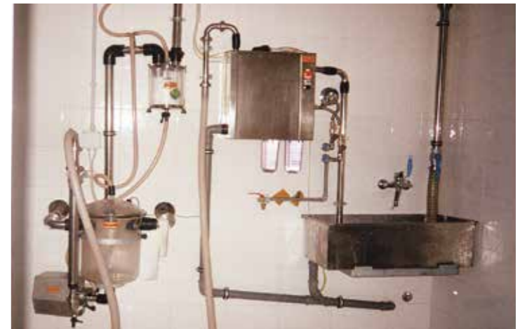
Group terminal pour salle de milking
